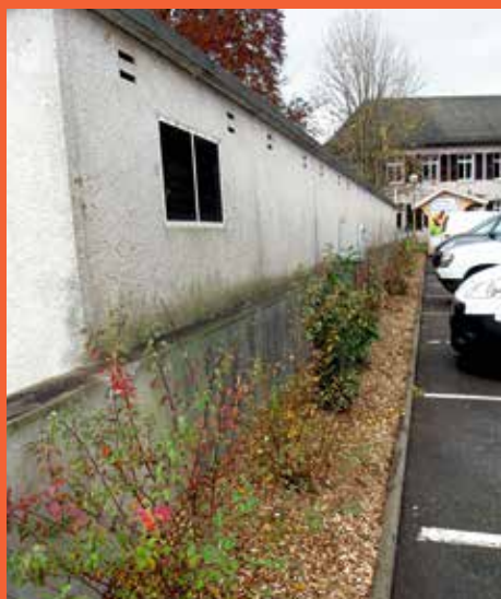
Plantation d'une haie le long du parking de la rue du cerf
