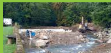
Travaux sur la Thur - consolidation des berges Et réalisation d'une passe à poissons
