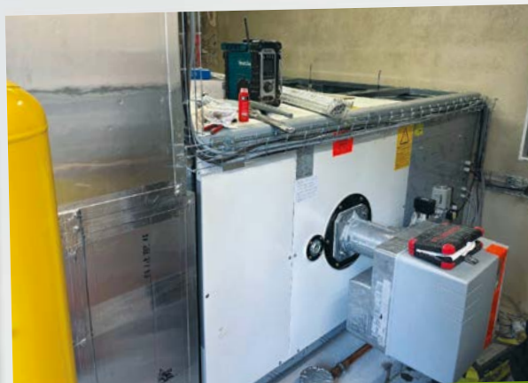
Notre église a été équipée d'une nouvelle chaudière.
