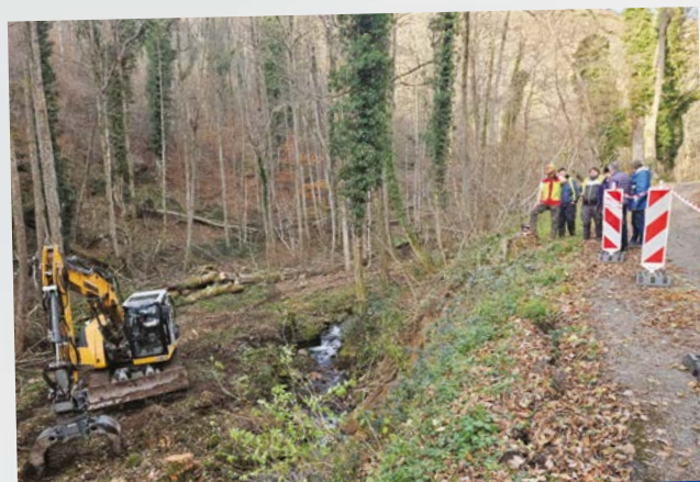
D'importants travaux de consolidation des berges du Vogelbach ont été entrepris suite à l'écroulement d'une zone.
